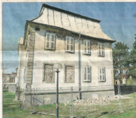
Das Barbyer Herrenhaus verfällt seit rund 25 Jahren. Die Notsicherung ist fast überfällig. Gibt es jetzt Hoffnung?
